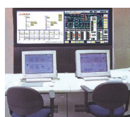
監視制御システム
